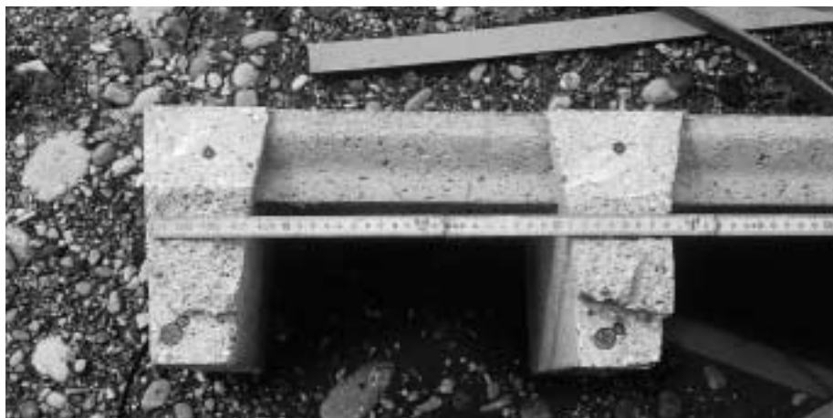
Fig. 3: Revêtement en béton insuffisant pour un nouveau caillebotis.
